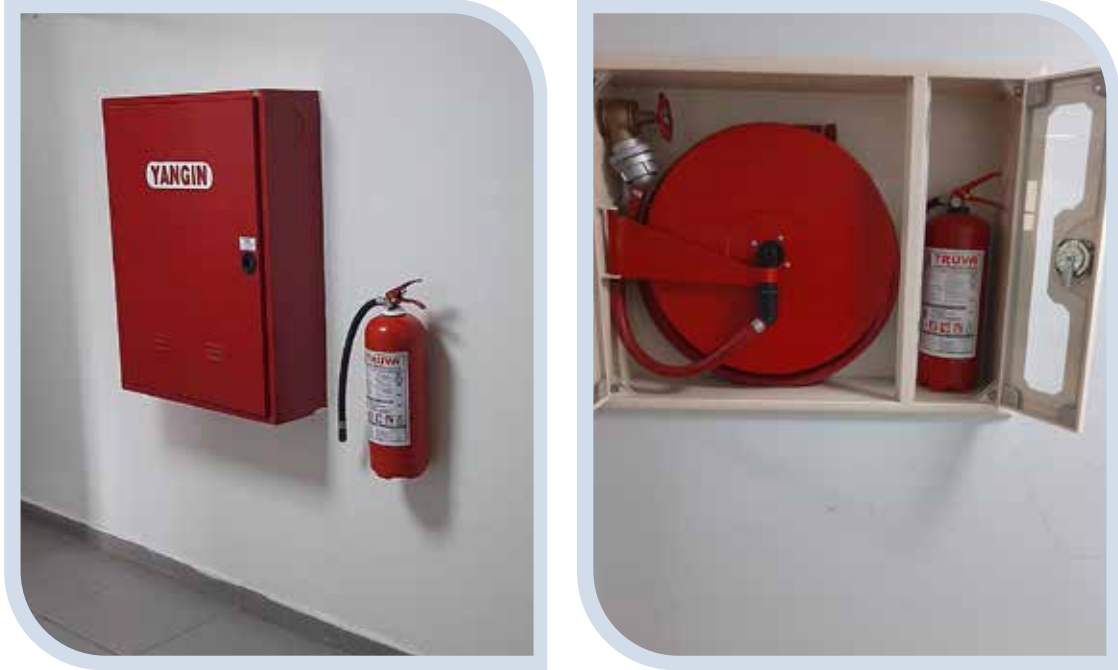
Belediye Binaları içerisinde yer alan yangın teçhizatı fotoğrafı
